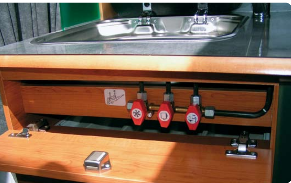
Die Gasarmaturen in der Küche hinter einer Klappe.
